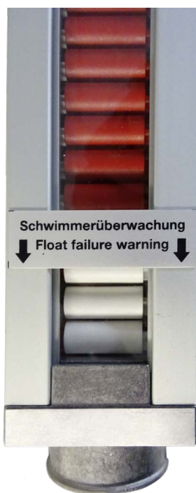
Schwimmer schwimmt (Behälter gefüllt)
