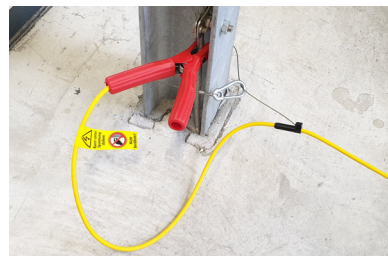
Erdung am Fundamenterder
