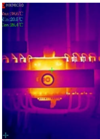
Inspektion von Elektroanlagen
