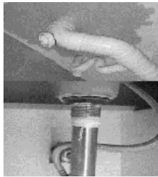
Leck in der Wasserversorgung/ Leck im Wasserrohr
