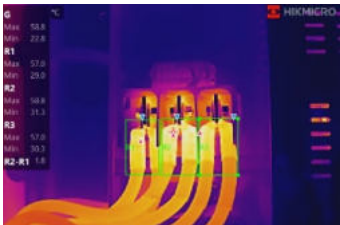
Überprüfung elektrischer Anlagen
