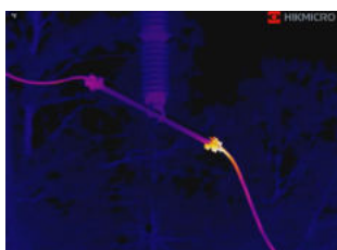
Probleme bei Steckverbindungen
